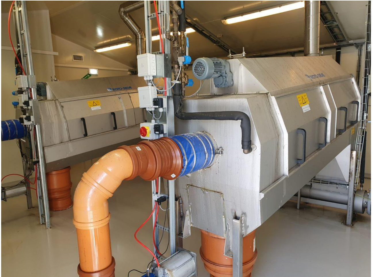
Figur 4-27 Renseanlegget på Storsteinnes. Foto fra befaring.
