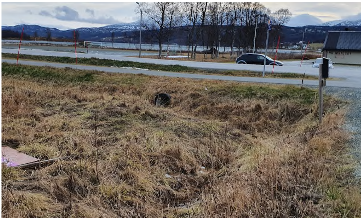
Bilde 1 - stikkrenne ved eksisterende innkjøring til skoletomten
